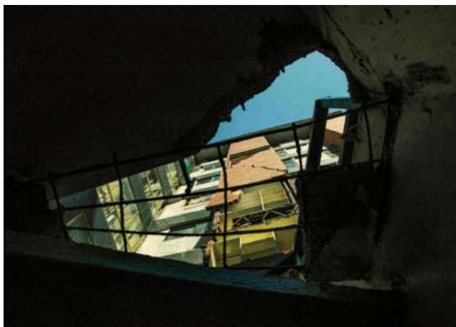
DAÑOS. Decenas de edificios, como este en la colonia Piedad Narvarte, fueron afectados por el sismo.
