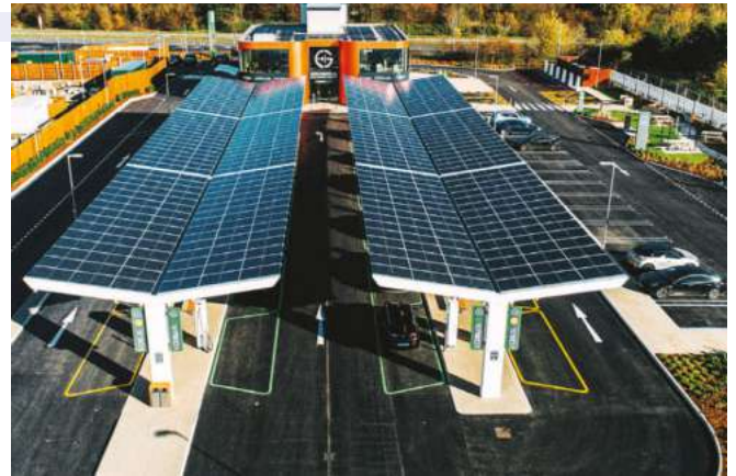
CARGADORES ABB. En 2020 abrió la primera estación de recarga 100% eléctrica de alta potencia en Reino Unido.
